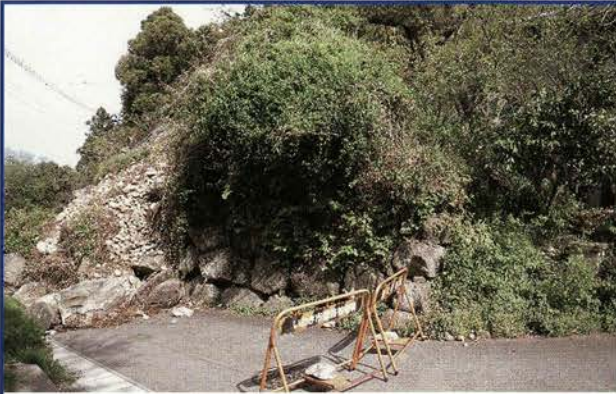
崩落した市指定史跡磐城平城塗師櫓石垣
